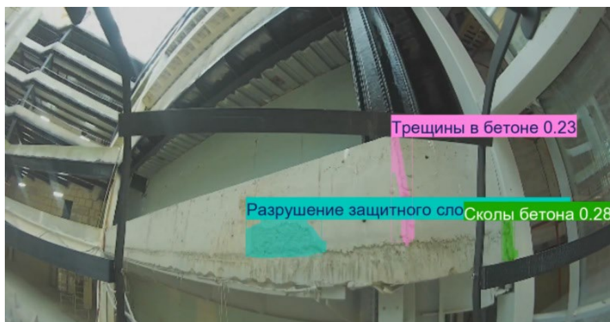
Рис. 4. – Обнаружение различных дефектов в процессе облёта заданного маршрута (трещины, разрушение защитного слоя бетона)
