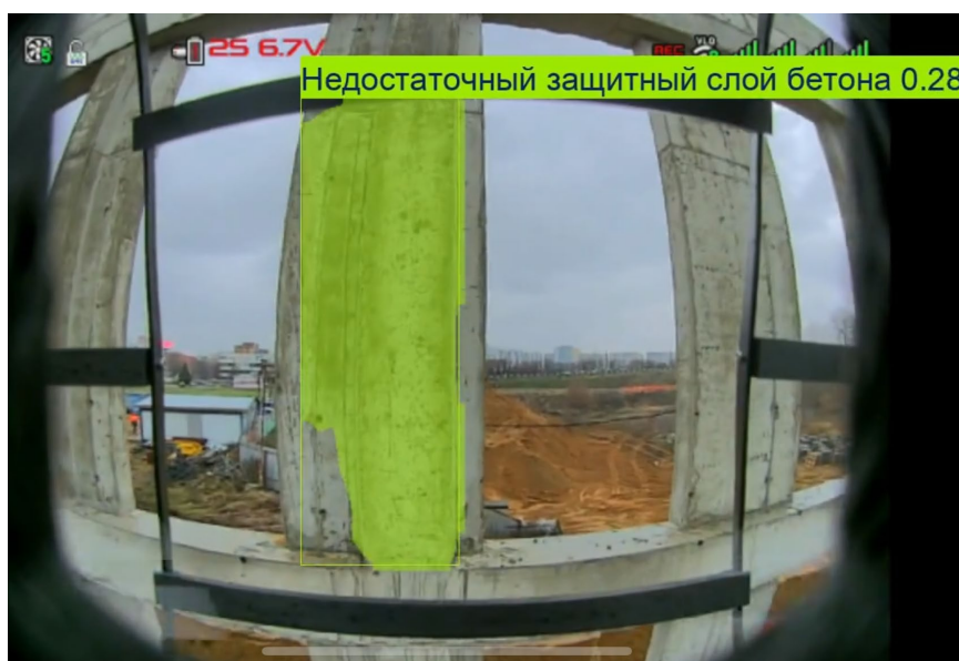
Рис. 5. – Обнаружение различных дефектов в процессе облёта заданного маршрута (недостаточный защитный слой бетона)
