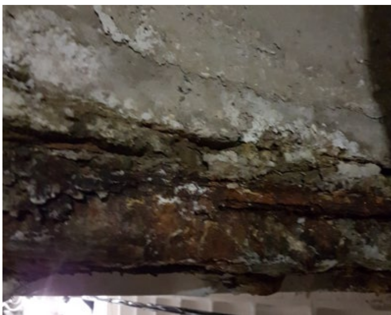
Рис. 2. Разрушение бетона в зоне сопряжения с арматурой
