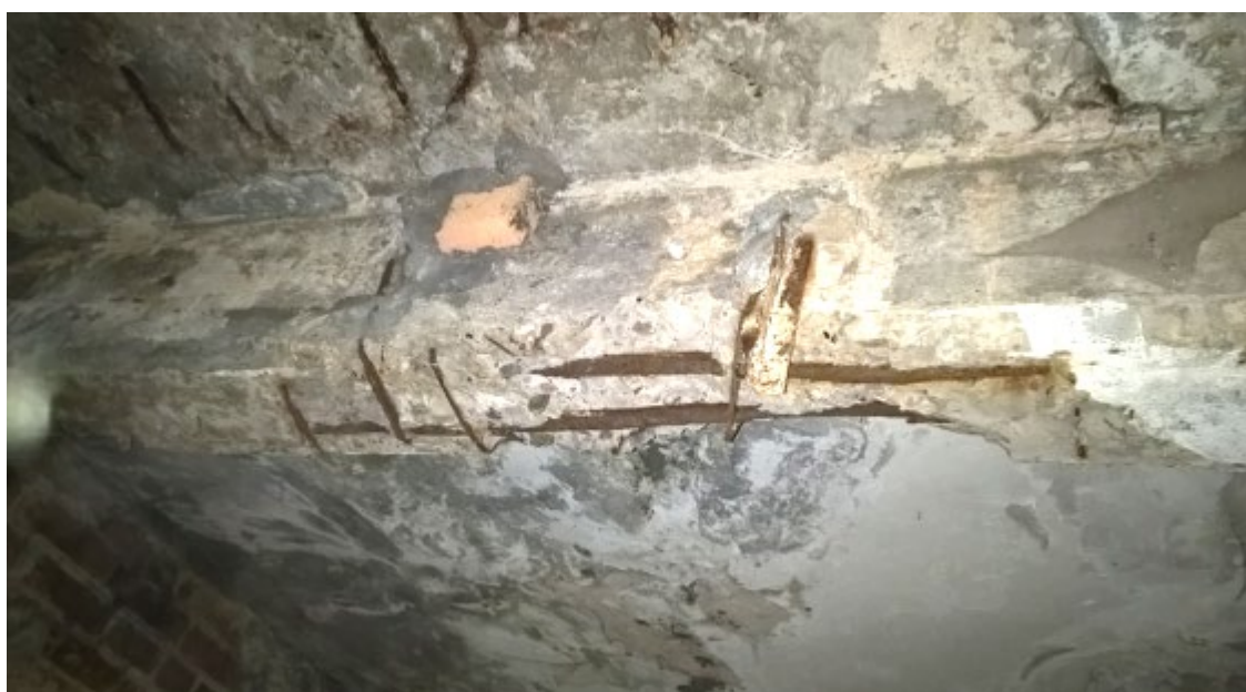
Рис. 1. Разрушение защитного слоя бетона конструкций
