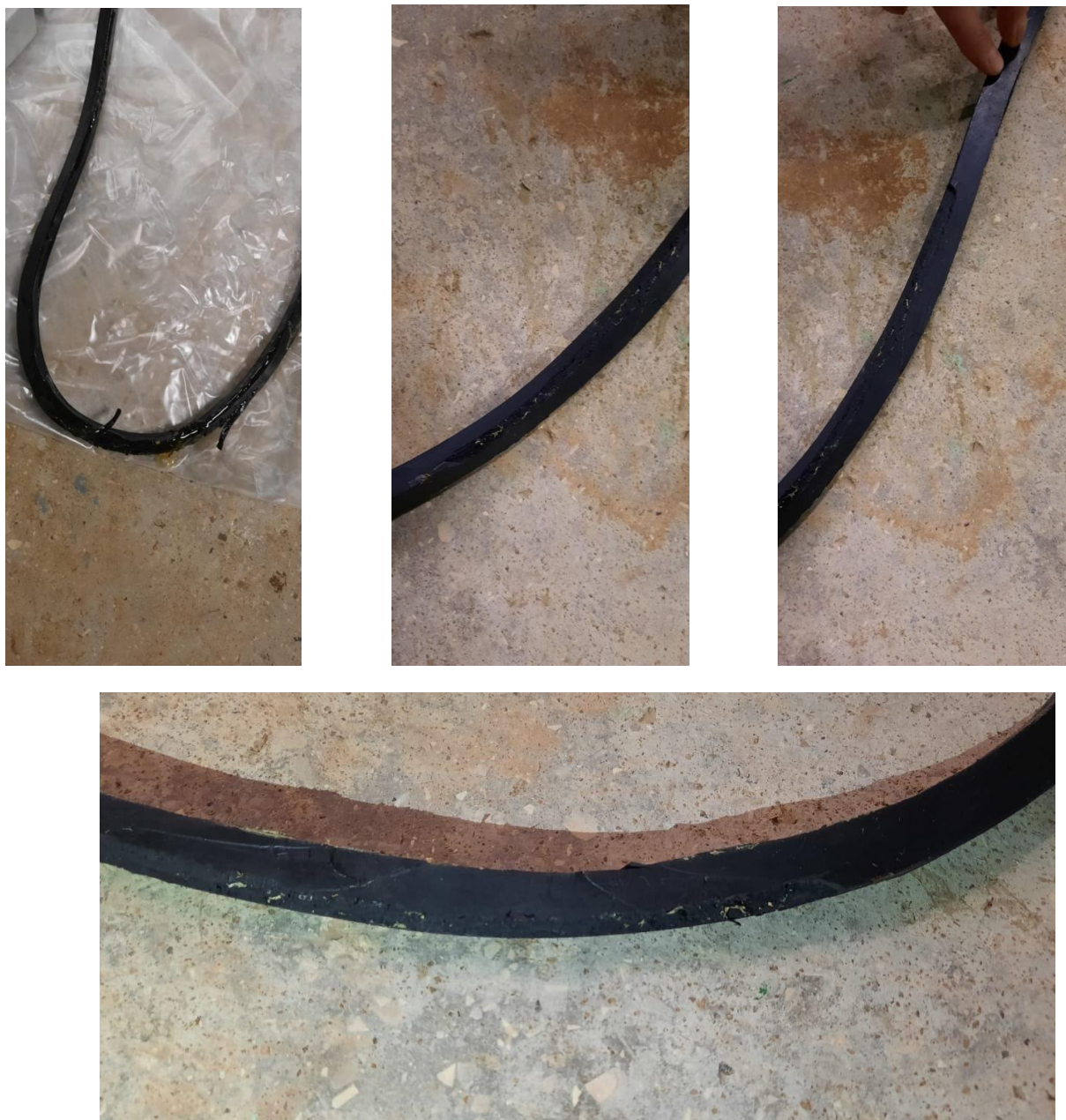
Рис. 18 – Поврежденная резиновая прокладка.
